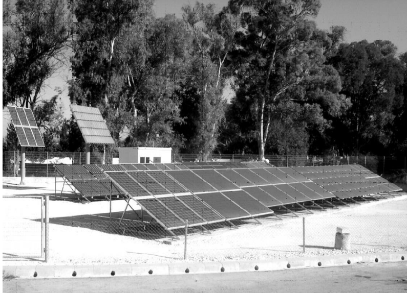
Εικόνα Νο.3: Προβολή του φωτοβολταϊκού πάρκου UCY
