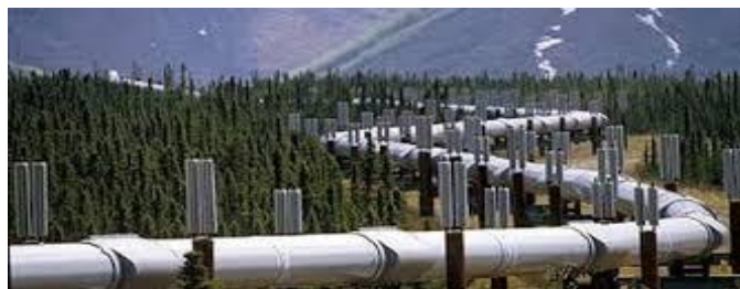
Εικόνα 13. Αγωγός μεταφοράς φυσικού αερίου ( www.epirusgate.blogspot.com )
