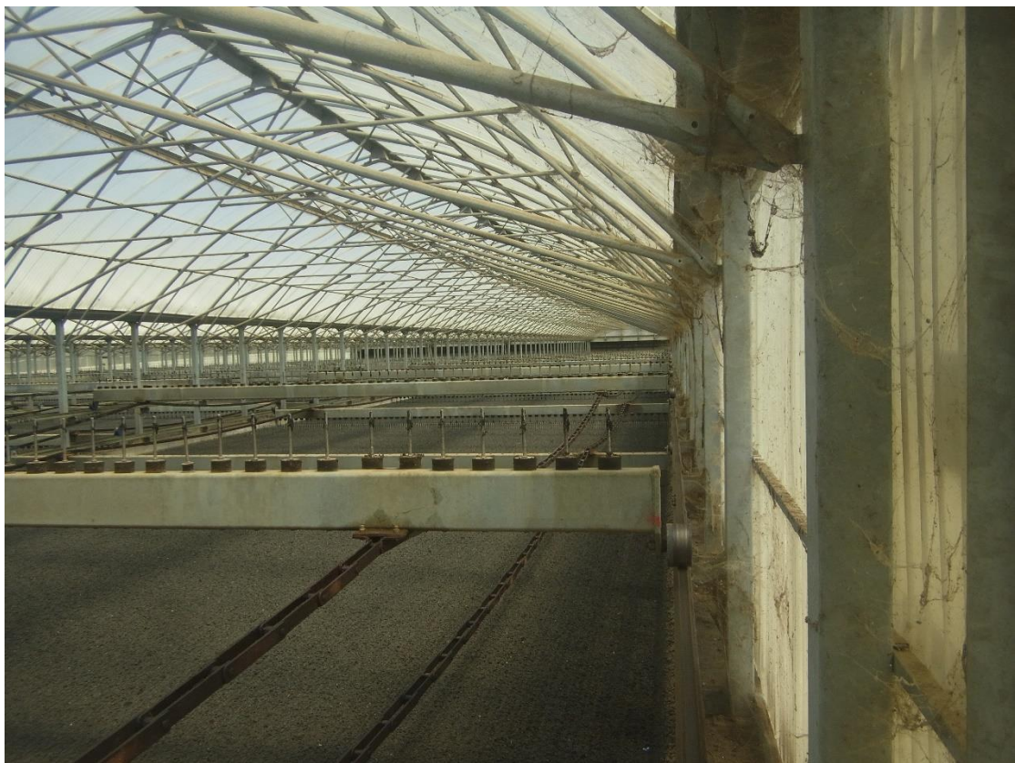
Εικόνα 26: Εγκαταστάσεις επεξεργασίας ιλύος.
