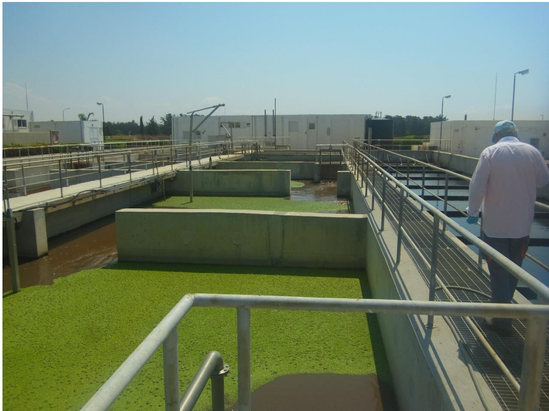
Εικόνα 12: Εγκαταστάσεις βιολογικής επεξεργασίας
