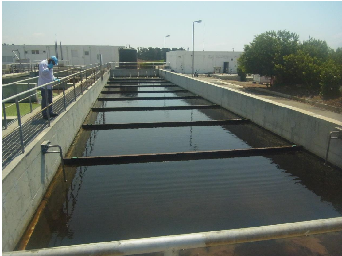
Εικόνα 14: Εγκαταστάσεις βιολογικής επεξεργασίας
