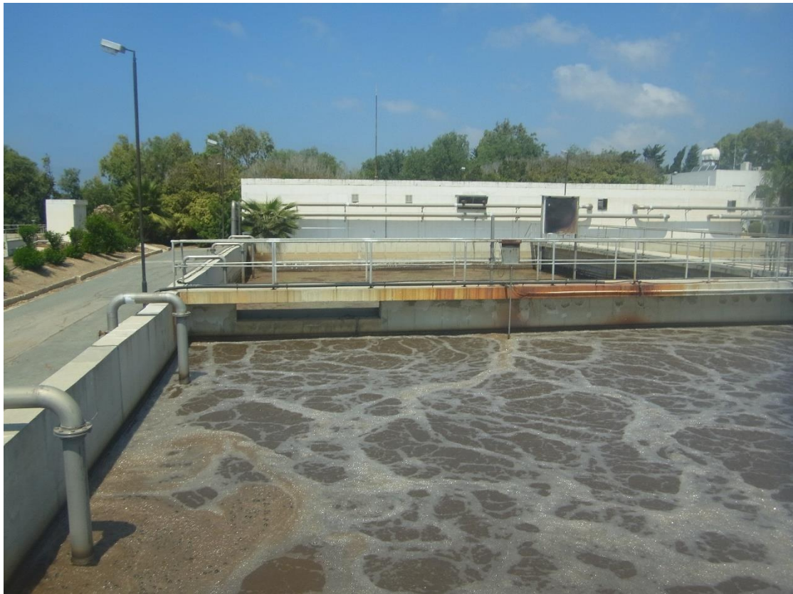
Εικόνα 16: Εγκαταστάσεις βιολογικής επεξεργασίας
