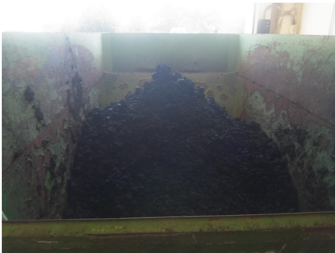
Εικόνα 28: Εγκαταστάσεις επεξεργασίας ιλύος.
