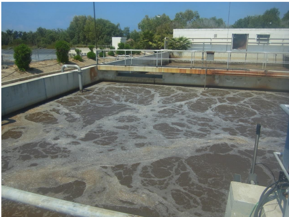
Εικόνα 13: Εγκαταστάσεις βιολογικής επεξεργασίας
