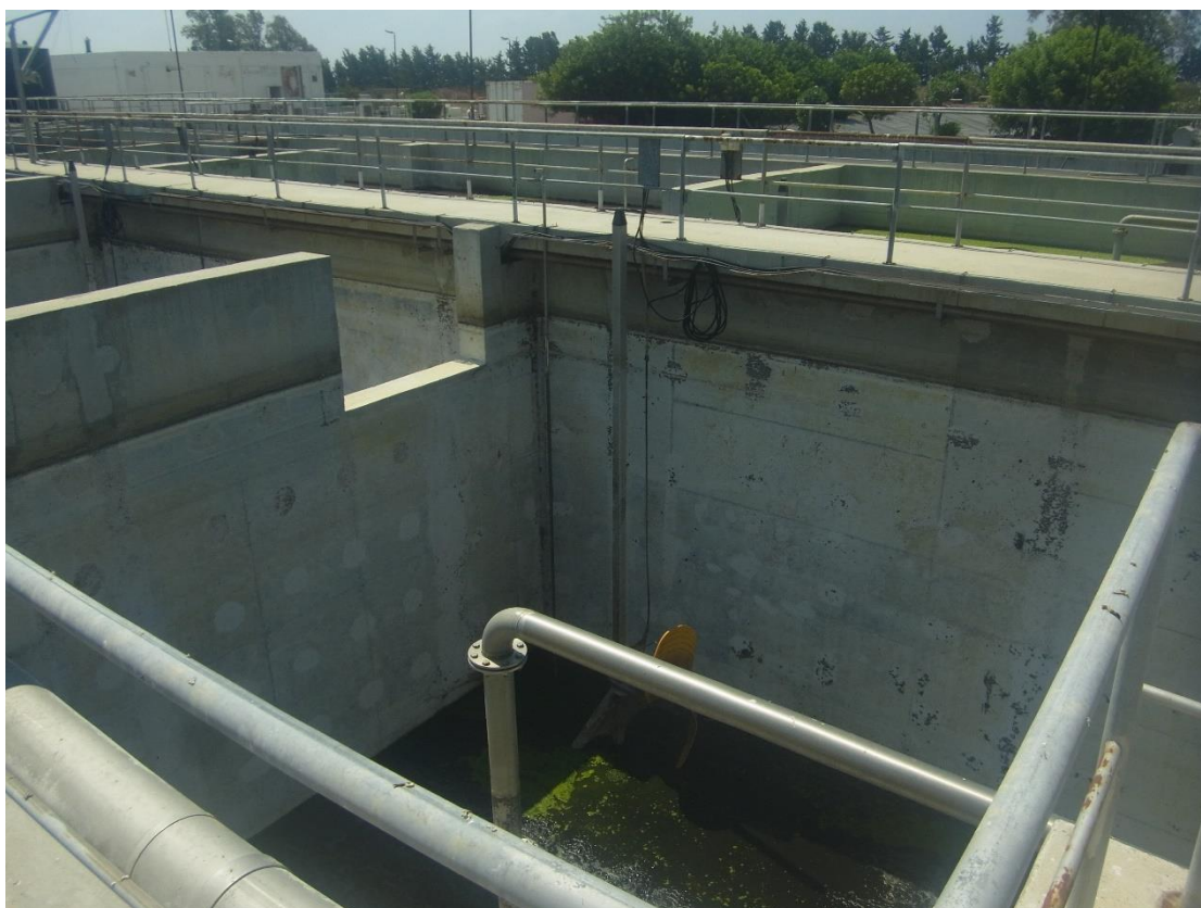
Εικόνα 8: Εγκαταστάσεις βιολογικής επεξεργασίας
