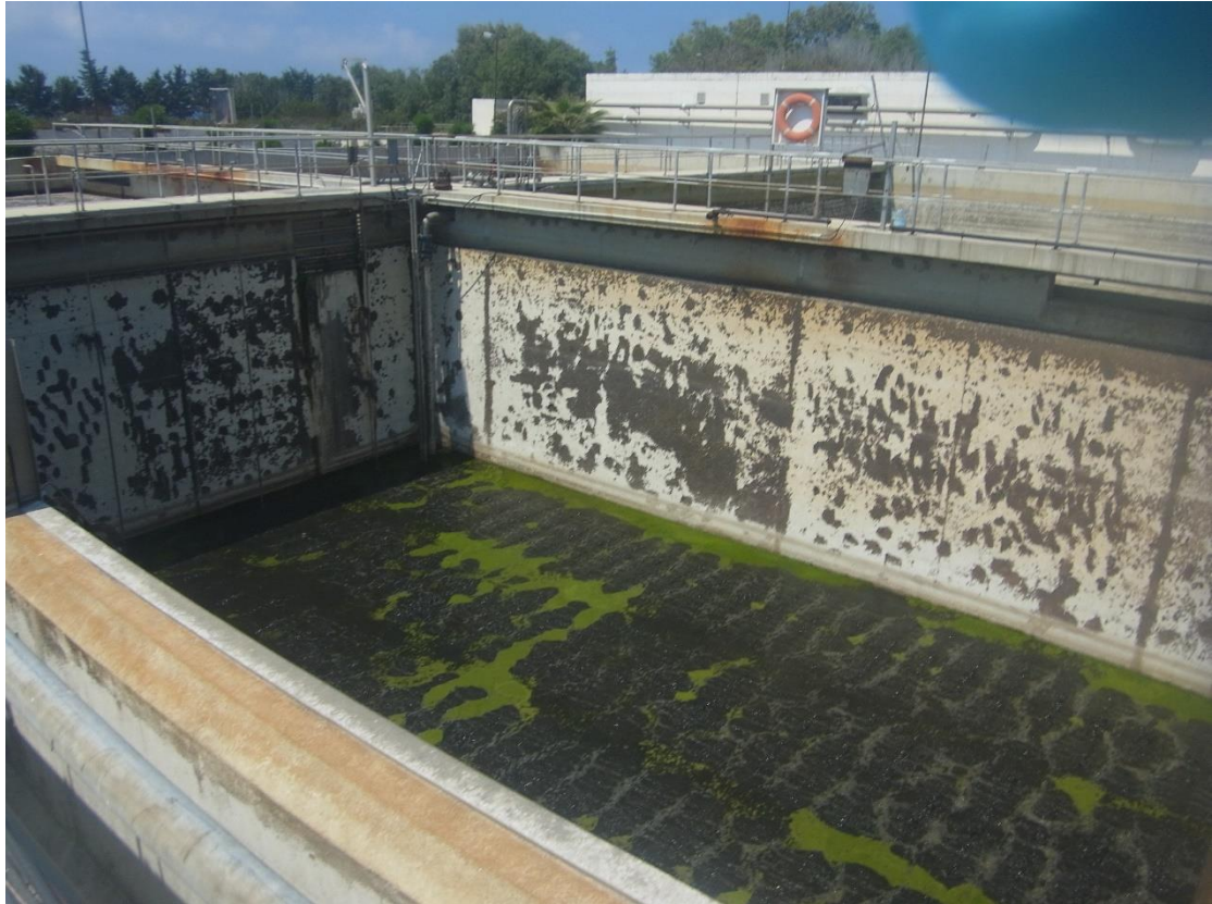
Εικόνα 7: Εγκαταστάσεις βιολογικής επεξεργασίας
