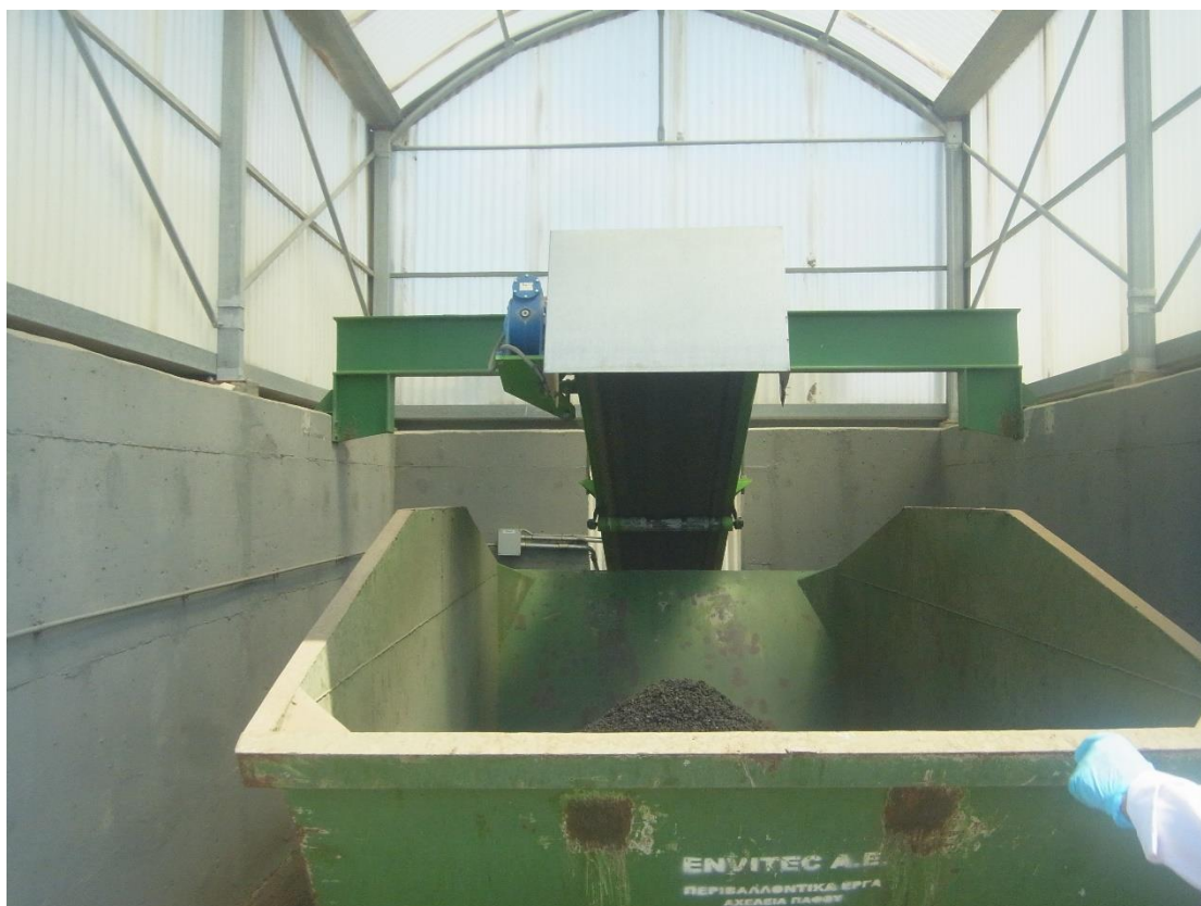
Εικόνα 27: Εγκαταστάσεις επεξεργασίας ιλύος.
