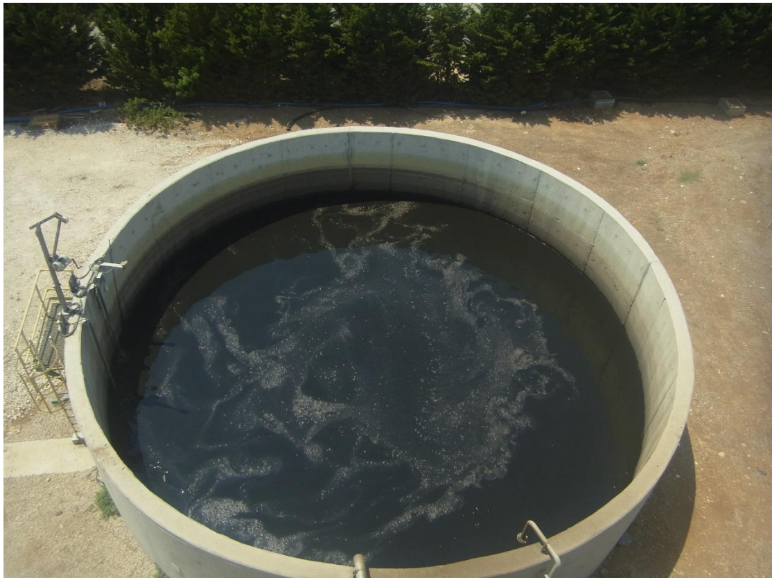
Εικόνα 25: Εγκαταστάσεις επεξεργασίας ιλύος.
