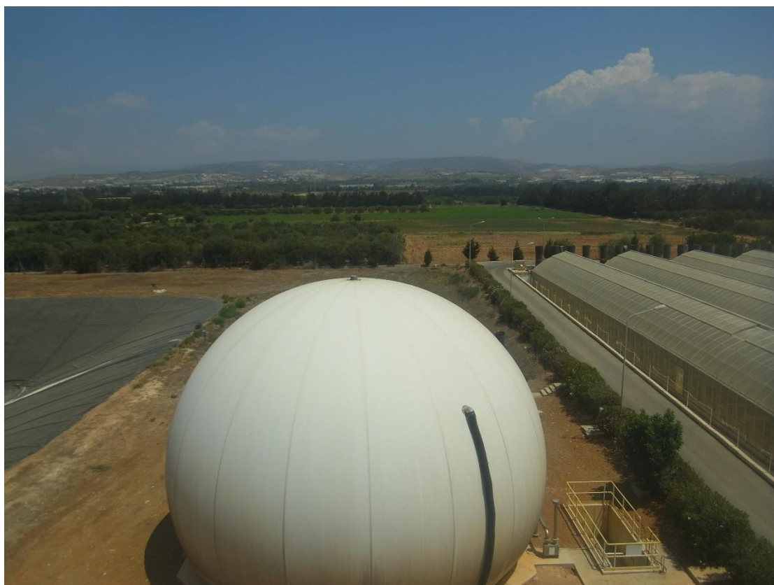
Εικόνα 23: Εγκαταστάσεις επεξεργασίας ιλύος.
