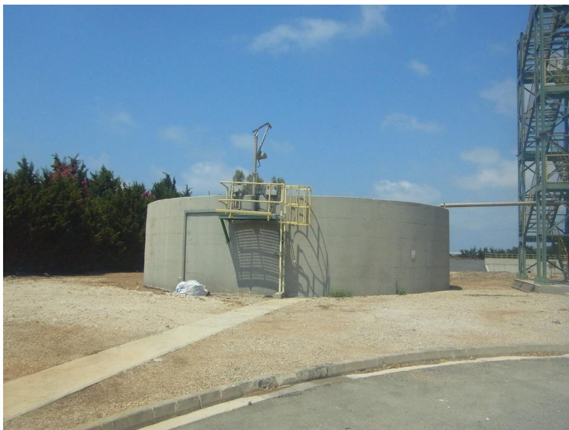
Εικόνα 24: Εγκαταστάσεις επεξεργασίας ιλύος.
