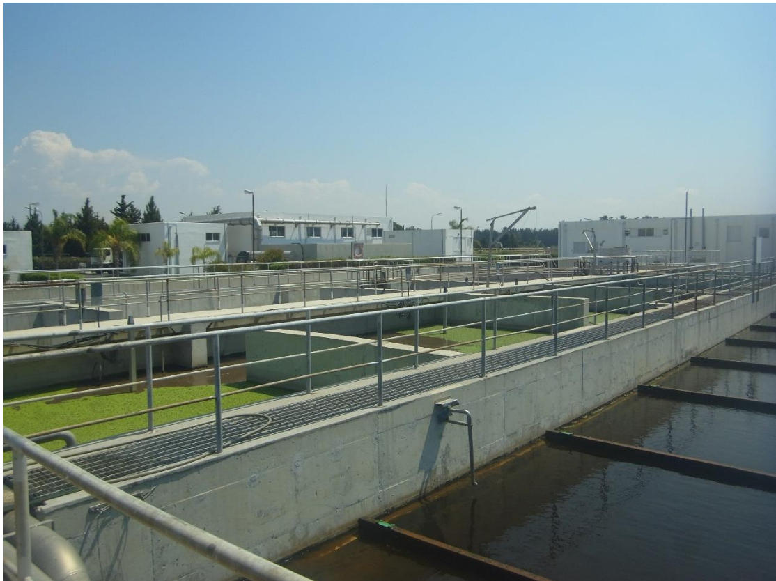
Εικόνα 18: Εγκαταστάσεις βιολογικής επεξεργασίας
