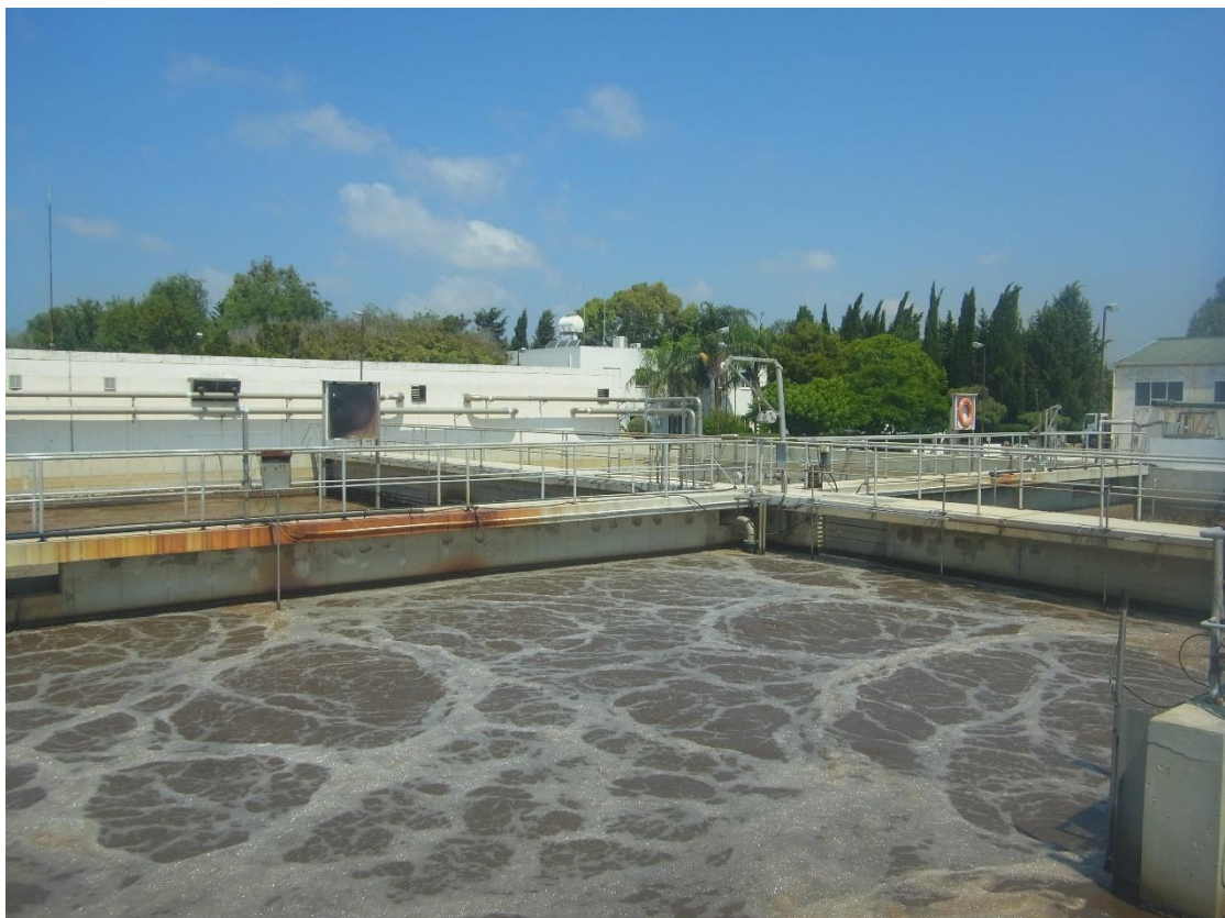
Εικόνα 15: Εγκαταστάσεις βιολογικής επεξεργασίας
