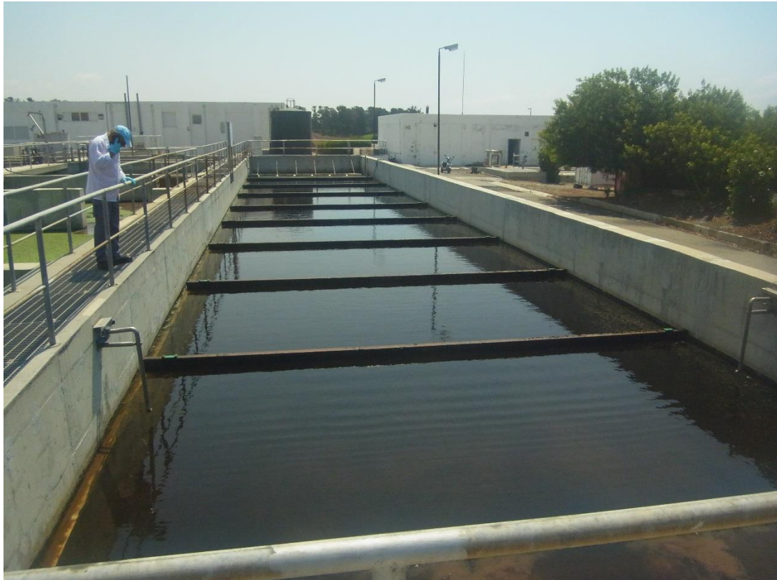
Εικόνα 14: Εγκαταστάσεις βιολογικής επεξεργασίας
